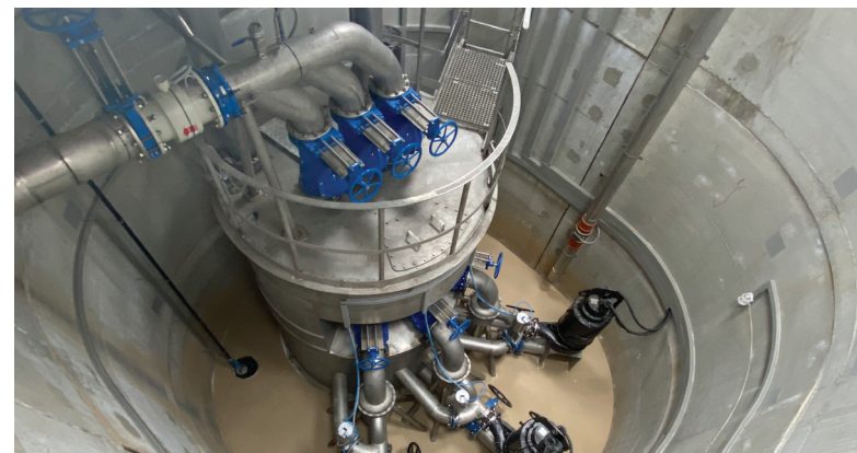
Urządzenia do tłoczenia ścieków Wodociągi zamontowały w głębokiej i suchej studni. Tłocznia jest bardzo wydajna i szczelna, dzięki czemu nie emituje odorów
